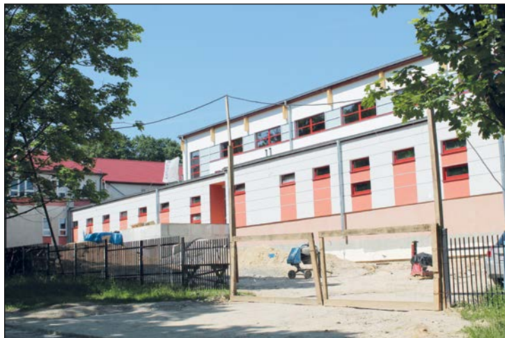
Budynek pełnowymiarowej hali sportowej przy PG w Przysusze już stoi, trwają prace wewnątrz obiektu
