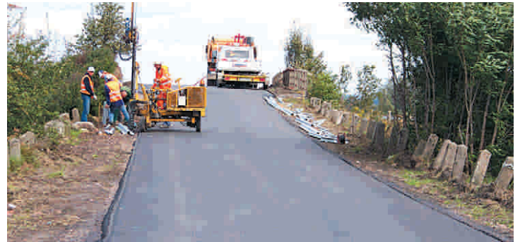
Instalowanie barier na wiadukcie kolejowym to ostatnie prace przy budowie drogi Smogorzów - Janików.
