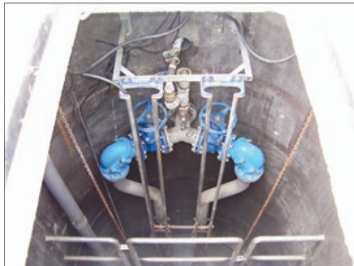
Pompy w przepompowni ścieków w Janikowie
